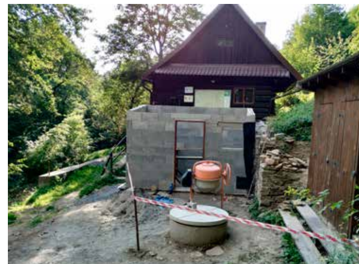
V popředí zakrytý vodní vrt, za ním stavba umývárny, vzadu chalupa Kusalína (foto: Jiří Homolka)
